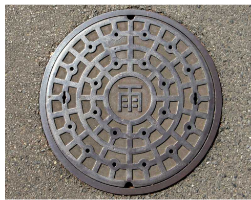
マンホールの蓋
