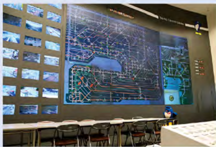
交通管制センター
